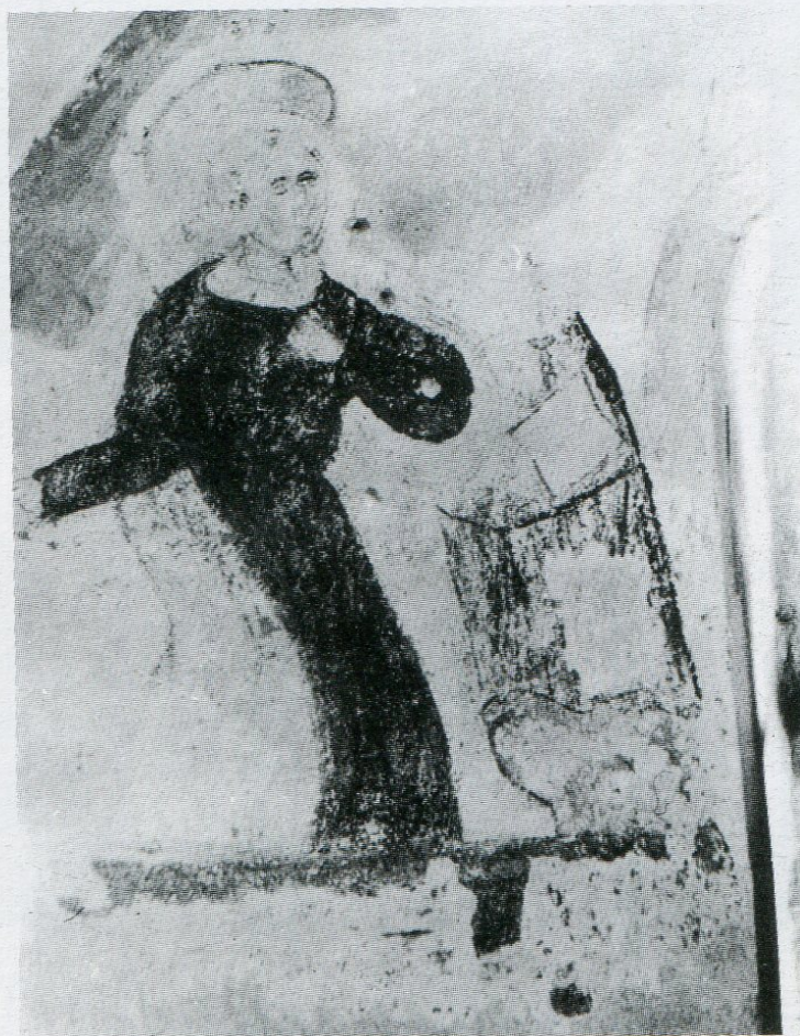
11. Bílý Kámen, iluzivní malba na vstupní stěně (část), stav během restaurátorských prací v roce 1995.
