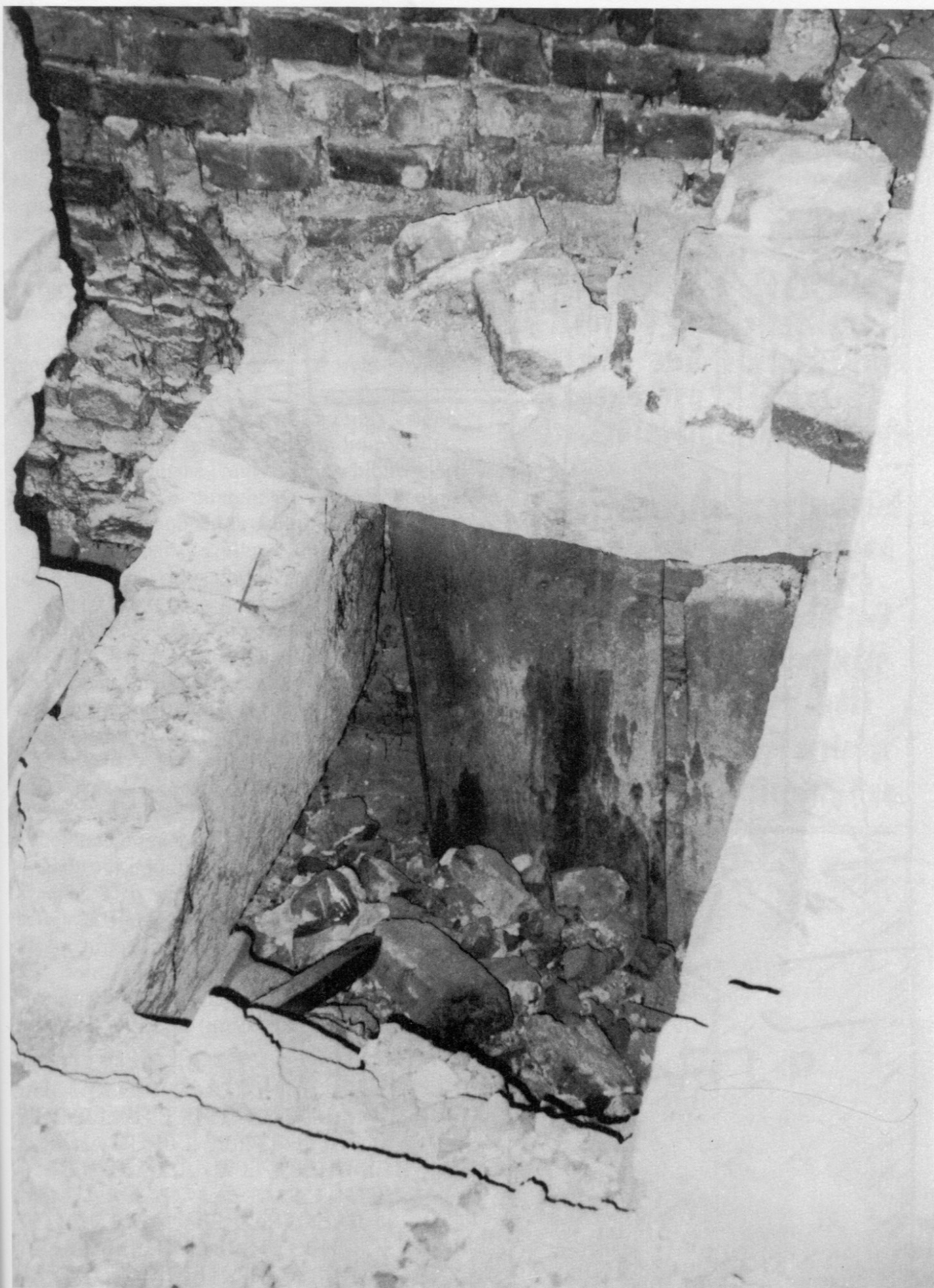
2. Pohled do šachty prevetu (krakorce, zbytky bednění), Jihlava, Znojemská 10. Foto D. Novotná.
